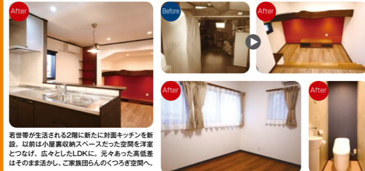
若世帯が生活される2階に新たに対面キッチンを新設。以前は小屋裏収納スペースだった空間を洋室とつなげ、広々としたLDKに。元々あった高低差はそのまま活かして、ご家族団らんのつづき空間へ。
